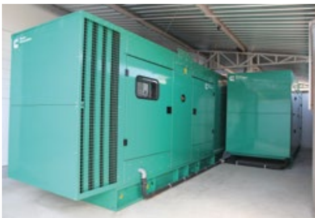
Grupos geradores diesel para teste de equipamentos de alta potência em plena carga.
